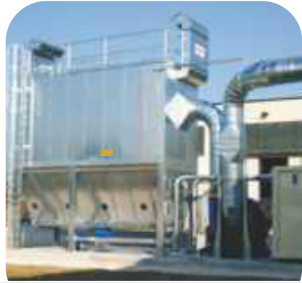
Φιλτρομονάδα με σύστημα εξαγωγής υλικού Filter substation with extraction system
